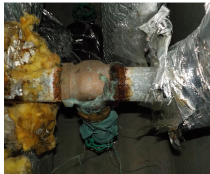
蒸気配管 配管腐食による蒸気漏れ (温水供給の停止)
