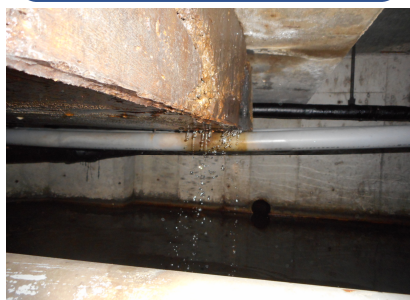
排水配管 配管劣化によるひび割れ 漏水（排水の停止）
